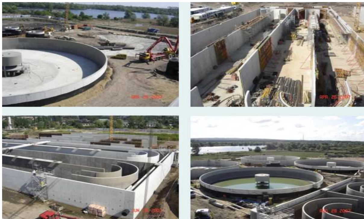
Fot. 9. Szczecin. Oczyszczalnia ścieków Pomorzany.
